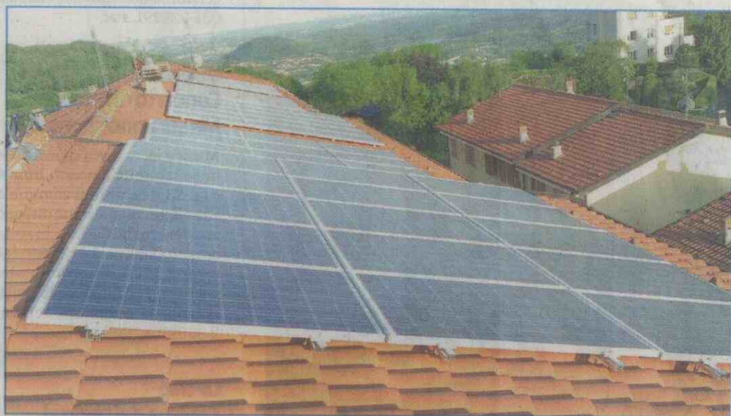
Pannelli fotovoltaici posizionati sopra un tetto
