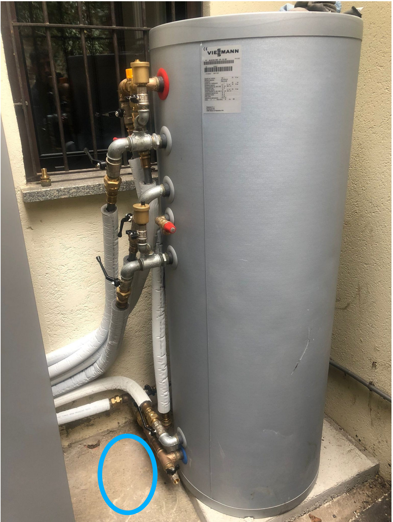
Fig. 51: Accumulo acqua tecnica (Blu: vaso di espansione non ancora installato)
