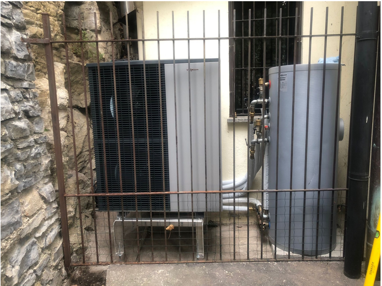
Fig. 53: Macchina esterna ed accumulo tecnico
