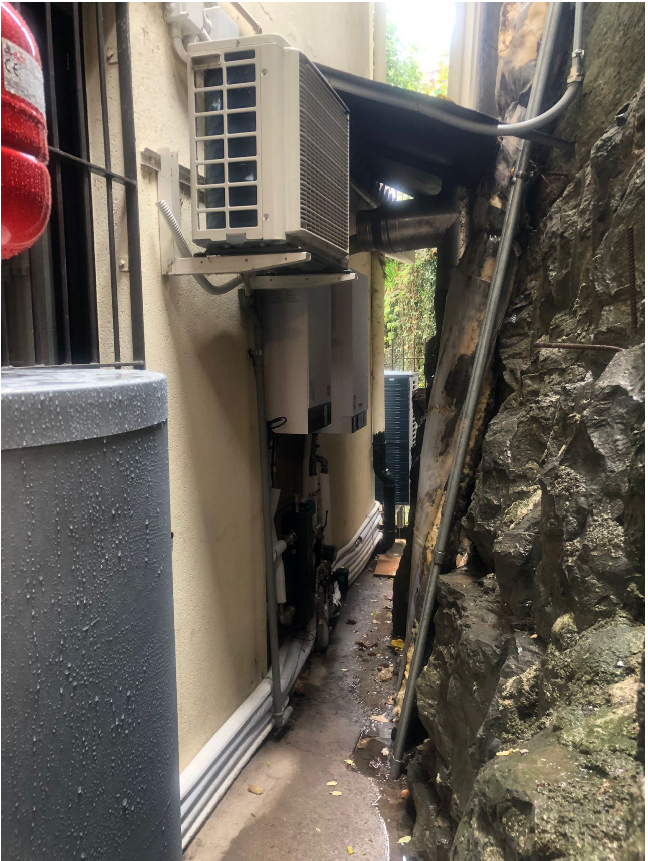
Fig. 49: Impianto, vista Est
