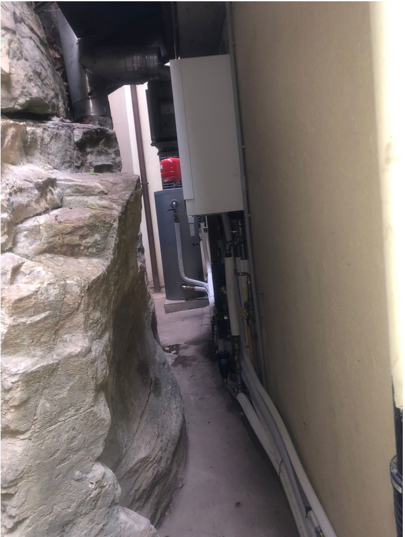
Fig. 50: Impianto, vista Ovest
